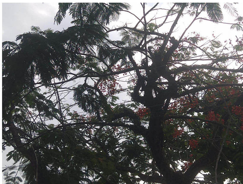
GALHOS ULTRAPASSANDO A FIAÇÃO 1
