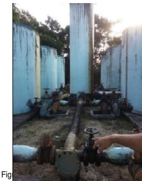
Figura 63. Vista interna dos filtros da ETA. Fonte: MJ Engenharia.
