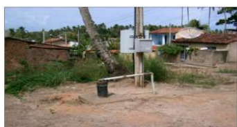
Figura 42. Poço de captação da CASAL
