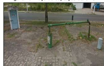
Figura 48. Poço de captação da CASAL
