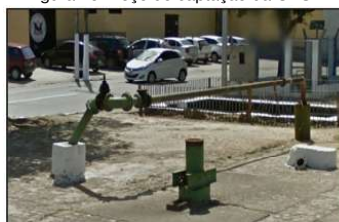
Figura 47. Poço de captação da CASAL
