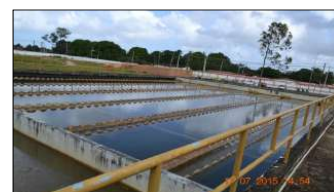
Figura 60. Decantadores. Fonte: MJ Engenharia.
