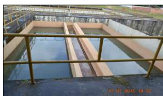
Figura 59. Filtros da ETA Pratygy. Fonte: MJ Engenharia.
