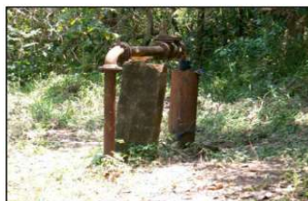
Figura 45. Poço de captação da CASAL
