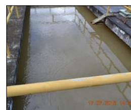
Figura 58. Câmara de Floculação. Fonte: MJ Engenharia.
